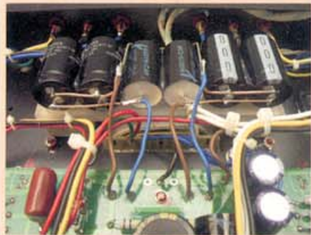
Eingebaut schaut das Ganze so aus. Die Anschlussleitungen gehen direkt an die entsprechenden Pins der Serien-Elkos C1 und C2. Damit das ohne Leitungskreuzungen funktioniert, ist ein Aufbau exakt wie der gezeigte unabdingbar. Wenn Sie mit der Maßnahme fertig sind, kleben Sie die Oberseite der Zusatzkondensatoren mit reichlich Isolierband ab, denn hier gibt's Hochspannung reichlich nah am Bodenblech des Verstärkers!
